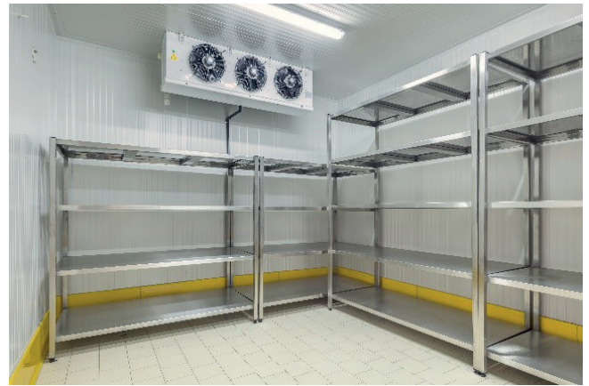
Figure 1 : Chambre froide positive composée d'une enceinte et comprenant un groupe de froid
